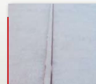
Poškodené tmelenie škár
